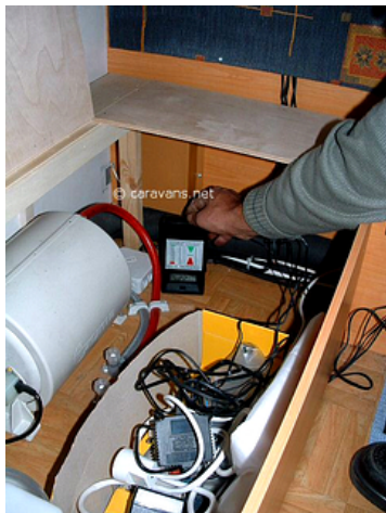
De boiler vormt een potentieel risico
