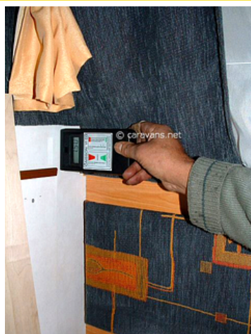
Vochtmeting voorwand/verbinding zijwand
